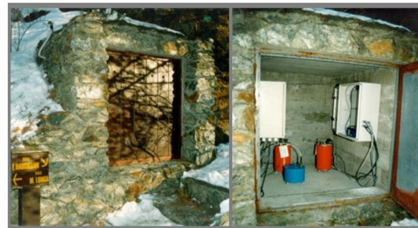
Sensore velocimetrico Geotech S-13 (associato alla vecchia strumentazione analogica) e sensore velocimetrico Lennartz LE-3D/5s (associato alla nuova stazione digitale) installati presso la stazione di BRMO, Bormio (SO) dell'ING. La stazione rappresenta una delle prime stazioni digitali con strumentazione sviluppata presso i laboratori dell'ING (acquirente GAIA).
