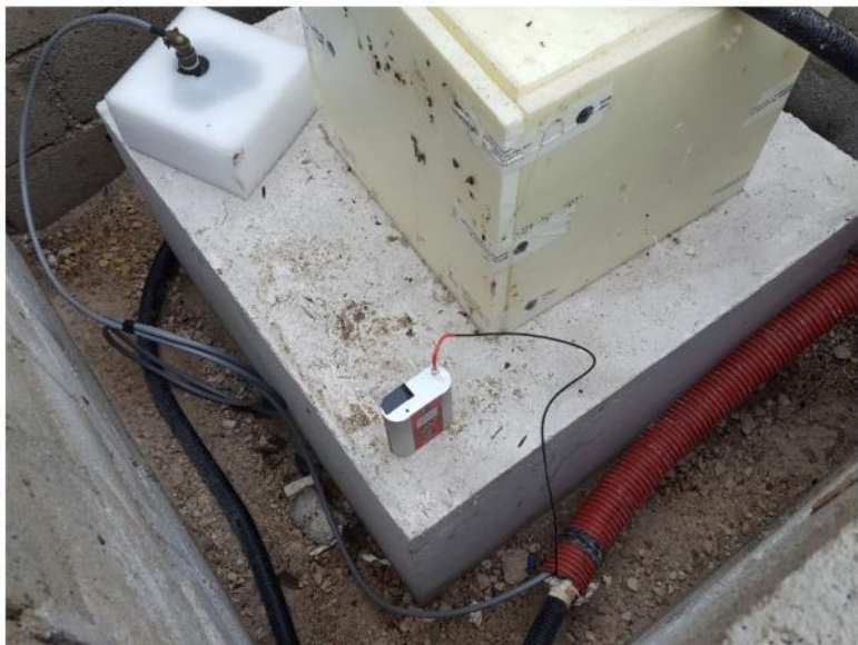
Stazione multiparametrica di LPEL-Lama dei Peligni (CH): sul pinto in cemento è stato installato, oltre al velocimetro e all'accelerometro, un misuratore di radon.
